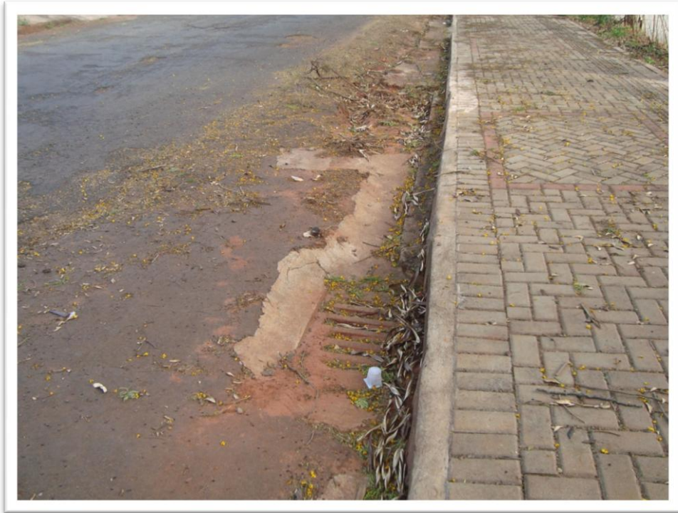
Figura 11: Mostra a Boca-de-Lobo “bueiro” entupido por resíduos sólidos (23/09/11) Autora: Huanny Izabely Paiva Ribeiro
